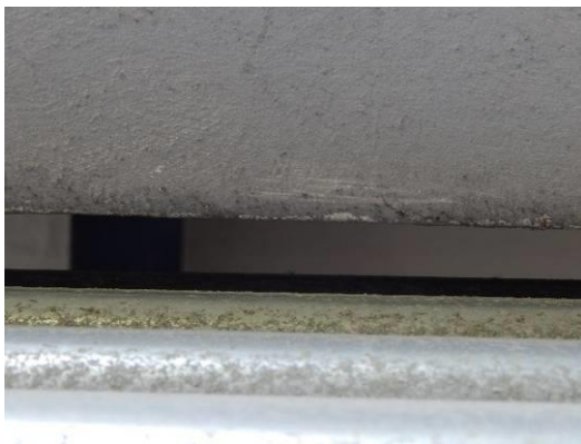
Abb. 56 Spalte am Rolltor der östlichen Halle.
