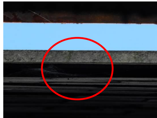
Abb. 52 Spalt zwischen Dachüberstand und Mauerwerk.
