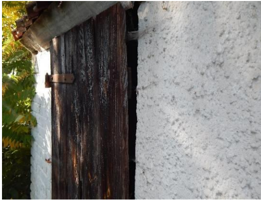
Abb. 48 Spalt an der Tür des Schuppens.
