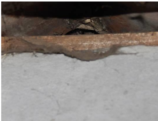
Abb. 54 Spalt am Dachüberstand zwischen Dachpfannen und -lattung.
