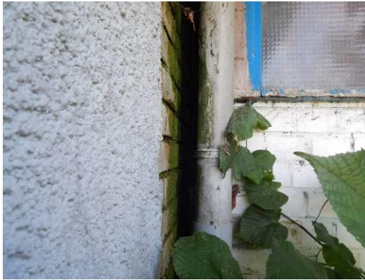
Abb. 57 Spalt im Übergang von Halle zu Verwaltungsgebäude. Keine Quartiereignung.
