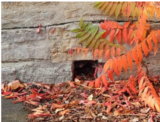
Abb. 58 Lüftungslloch im Mauerwerk der Schule.
