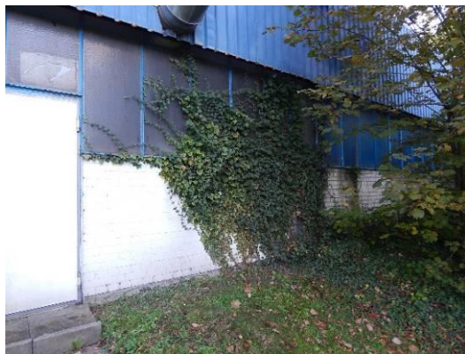
Abb. 53 Efeubewachsene nördliche Hallenfassade.
