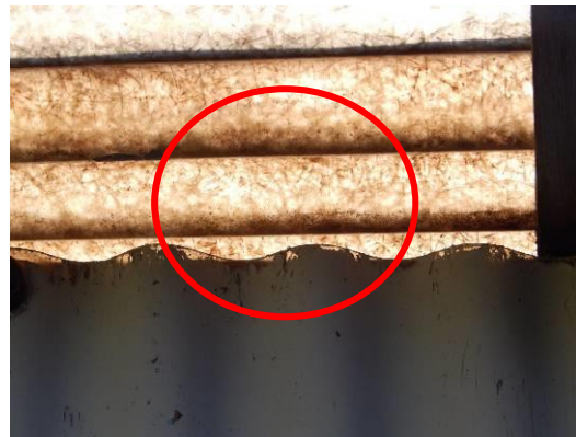
Abb. 46 Spalt im Übergang von Seiten- zu Dachverkleidung aus PVC-Wellplatten.
