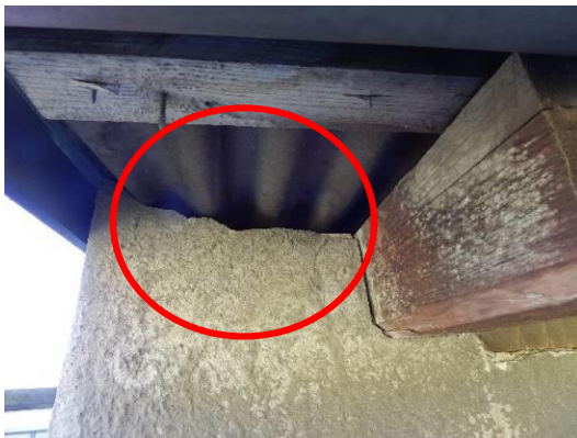
Abb. 44 Spalten im Übergang von Mauerwerk zu Dach am „Kontor“.
