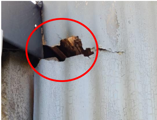
Abb. 47 Loch im Übergang von „Kontor“ zum südlichen Gebäudeteil.
