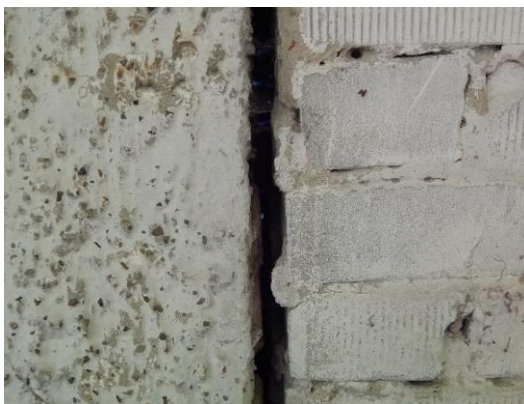
Abb. 50 Spalt im Mauerwerk des Schuppens.
