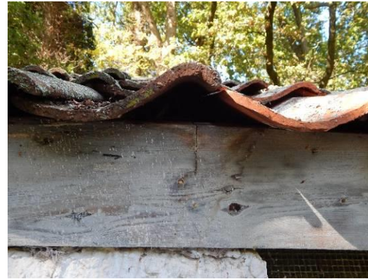
Abb. 49 Spalt zwischen Dachpfanne und Dachbalken.
