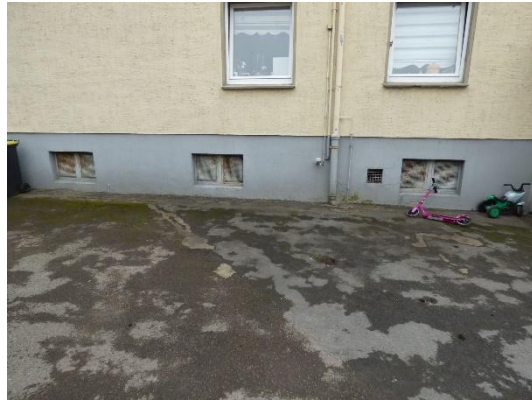
Abb. 49 Verschlussene Kellerfenster an der Nordseite des Wohnhauses.
