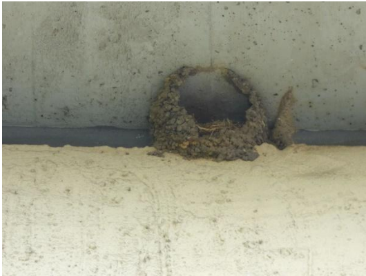
Abb. 48 Defektes Mehlschwalbennest an der Nordseite des Wohngebäudes.
