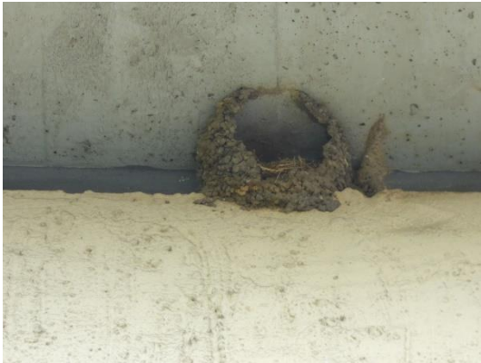
Abb. 48 Defektes Mehlschwalbennest an der Nordseite des Wohngebäudes.
