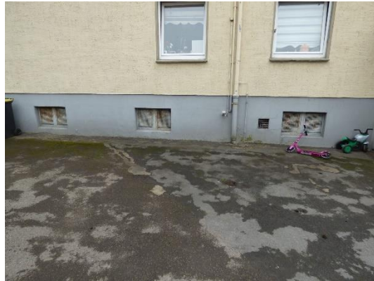
Abb. 49 Verschlussene Kellerfenster an der Nordseite des Wohnhauses.
