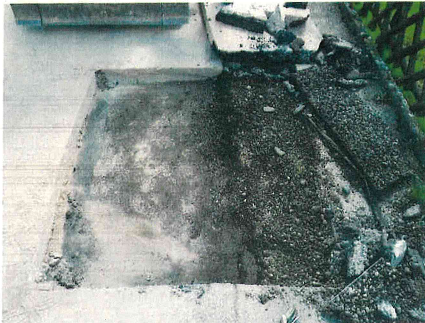
Abb. 15: Schurf 2: Schollenartig aus der Fahrbahn entfernte Asphaltbefestigung (oben rechts) und ebenfalls schollenartig entfernte Asphaltbefestigung aus dem Verbreiterungsbereich (rechts); als Unterlage ist die leicht feuchte Bitukies-Schicht sichtbar
