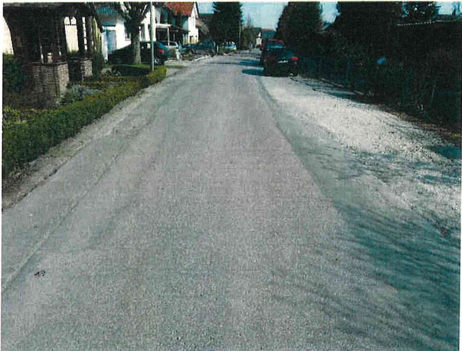
Abb. 3: Ca. 3 m breite Fahrbahn mit beidseitig vorhandenen, teilweise provisorisch asphaltierten Verbreiterungsbereichen (NKA 8555 008 nach 8555 004, ca. Station 90 m)
