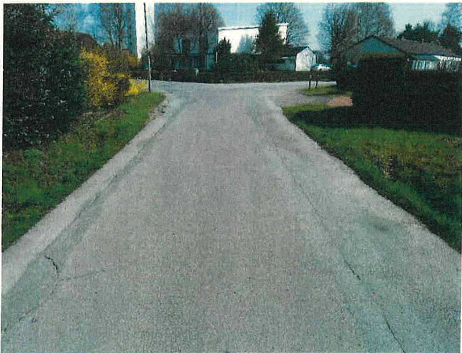
Abb. 4: Ca. 3 m breite Fahrbahn mit beidseitig vorhandenen, teilweise provisorisch asphaltierten Verbreiterungsbereichen und Entwässerungsgräben (NKA 8555 008 nach 8555 004, ca. Station 280 m)
